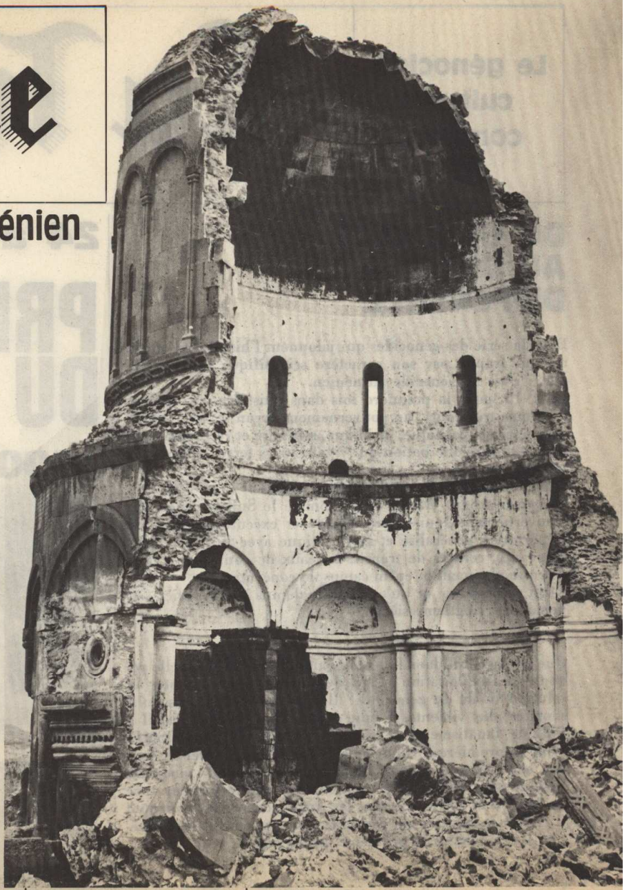
Ruines de l'église St-Sauveur érigée en 1036 : actuellement d'importantes lézardes menacent définitivement ce vestige.
